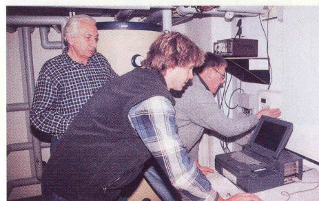
▲ Ein fest installierter Rechner und ein eigens von Josef (Sepp) Reisinger geschriebenes Programm steuert und überprüft permanent die Wärmepumpen-Anlage. Hier beim Datenabgleich: (v.l.): Gerd Badstübner, Josef Reisinger und Johann Naßl
